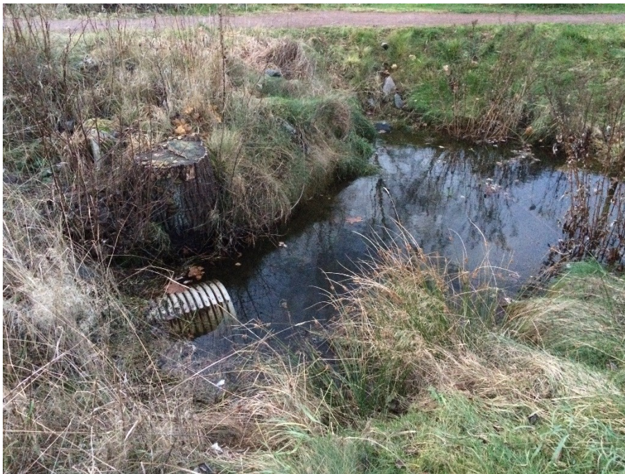
Figur 11 Utgående trumma från planområdet. Systemet är kraftigt belastat efter ihållande regn.
