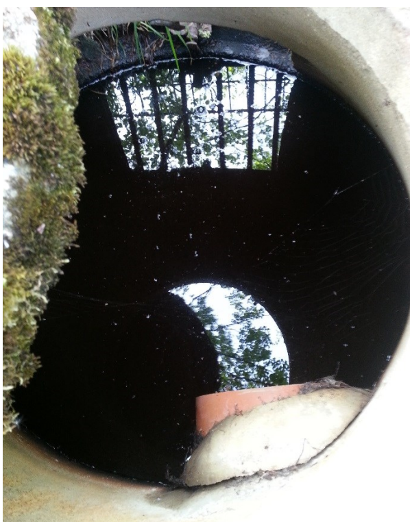
Figur 6 Intagsbrunn för Benarbäcken. Vid fototillfället har brunnslöcket öppnats och brunnens intagsgaller syns reflekterat i vattnet i bildens överkant.
