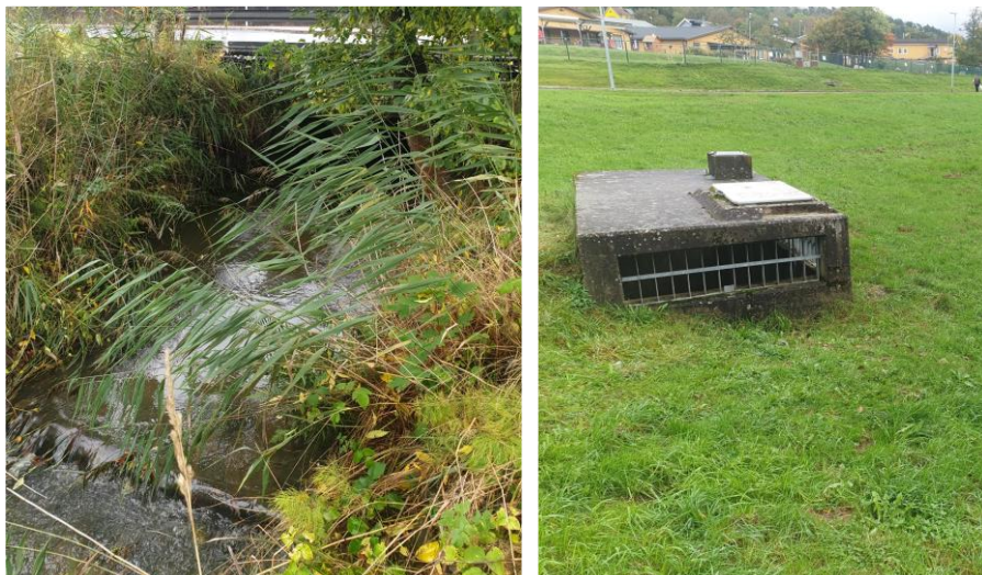
Figur 8. Till vänster ses en tröskel och i bakgrunden finns två trummor som i dagsläget ligger för högt. Till höger visas inloppet till den långa kulvert som mynnar vid Östergårds-skolan och utgör ett vandringshinder i dagsläget.
